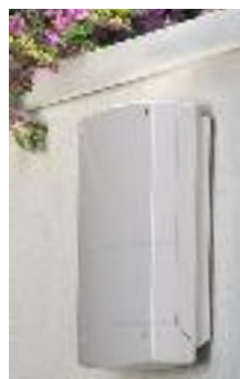
Technische module met niet-zichtbare antenne
